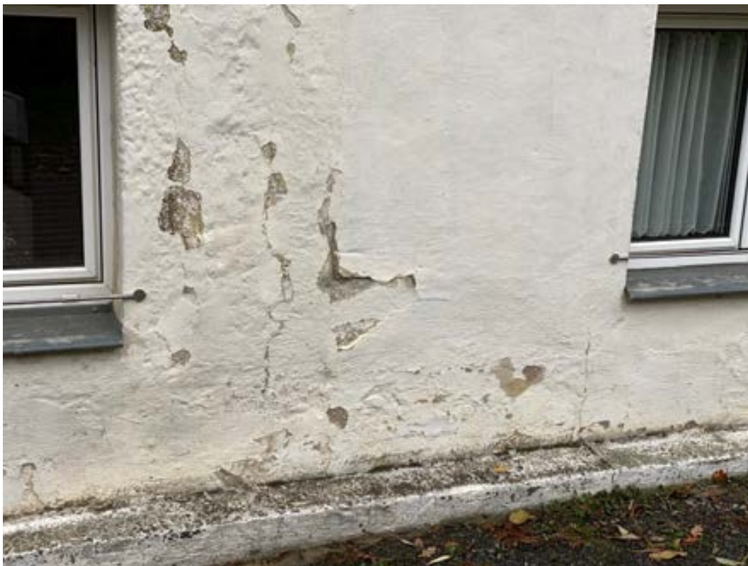
Schäden an der Fassade des Wohnhauses (Straßenseite)
