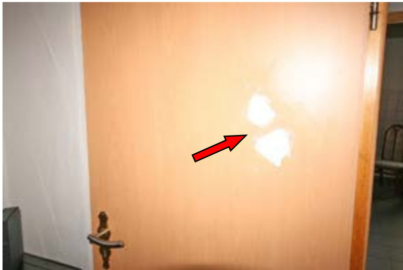
Bild 21: Schadhafes Türblatt im Wohnzimmer des Bewertungsobjekts
