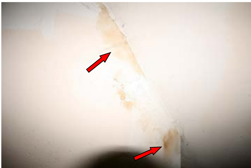
Bild 40: Feuchtigkeitsschäden an einem Kamin im Dachraum (Spitzboden) des Bewertungsobjekts
