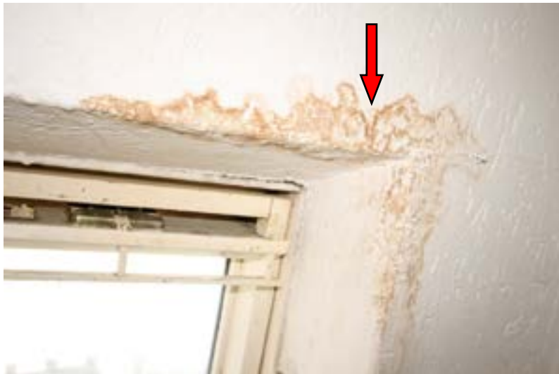
Bild 25: Feuchtigkeitsschaden am Dachflächenfenster in der Küche des Bewertungsobjekts
