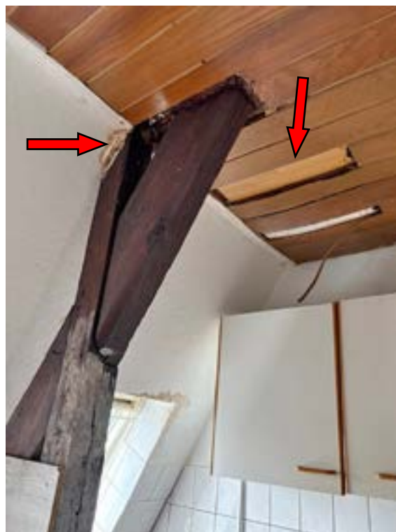
Bild 26: Feuchtigkeitsschaden an Dachbalken und sich lösende Deckenbekleidung in der Küche des Bewertungsobjekts
