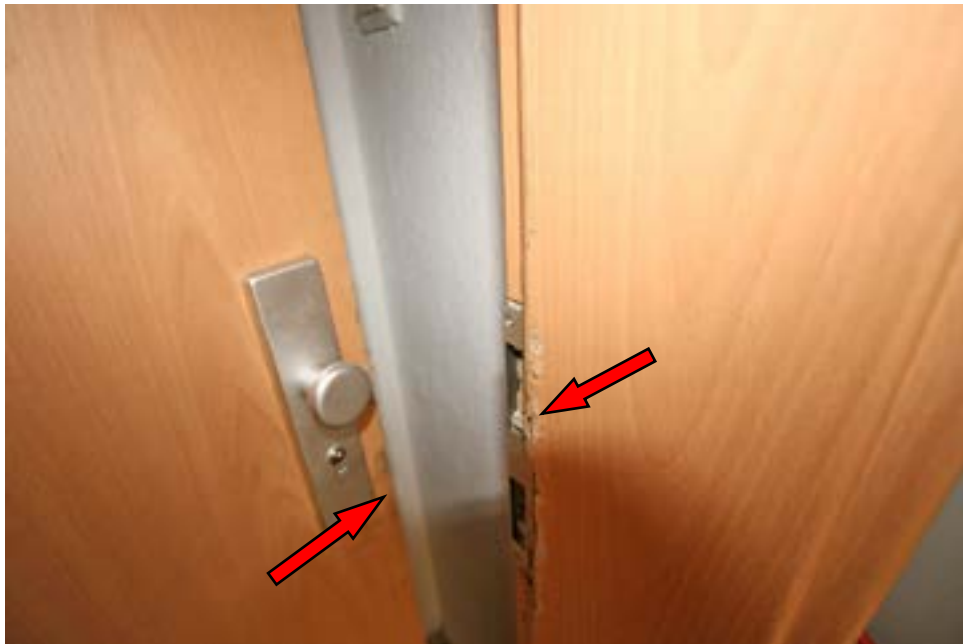
Bild 13: Schadhafte Wohnungseingangstürelement des Bewertungsobjekts
