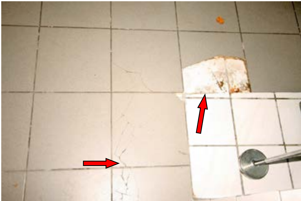
Bild 29: Schadhafte und nicht fachgerecht verlegte Bodenfliesen im Badezimmer des Bewertungsobjekts
