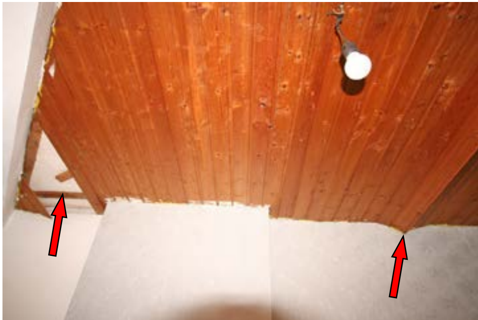
Bild 35: Lose und herabgefallene Deckenbekleidung im Badezimmer des Bewertungsobjekts
