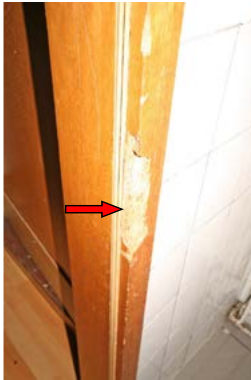
Bild 27: Schadhafte Türzarge in der Küche des Bewertungsobjekts
