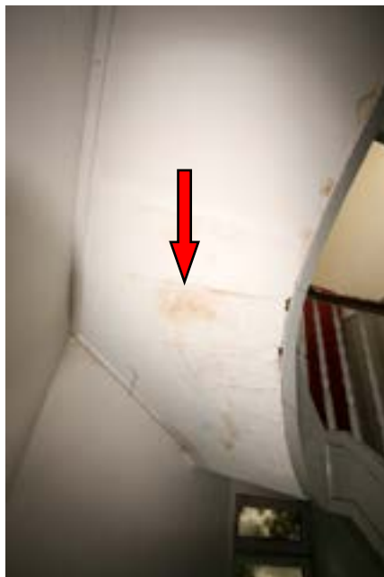
Bild 8: Feuchtigkeitsschäden an Untersicht der Geschosstreppe des Bewertungsobjekts
