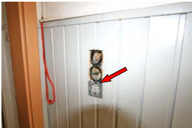
Bild 10: Offenliegende Elektroinstallation im Dachgeschoss des Treppenhauses des Bewertungsobjekts
