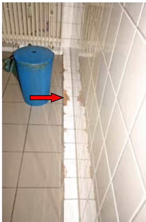
Bild 24: Schadhafter Fliesenbelag in der Küche des Bewertungsobjekts
