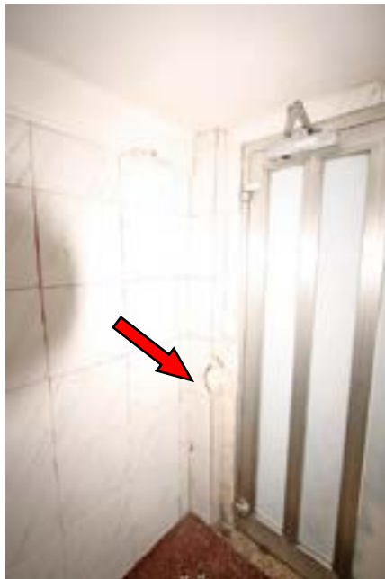
Bild 7: Schadhafte Wandfliesen im Hauseingangsbereich des Bewertungsobjekts
