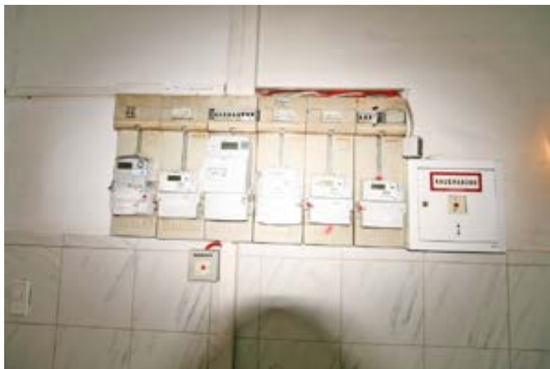
Bild 6: Zu modernisierende Elektroverteilung des Bewertungsobjekts
