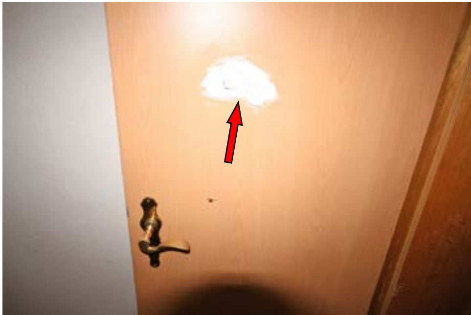
Bild 19: Schadhafes Türblatt im Kinderzimmer des Bewertungsobjekts
