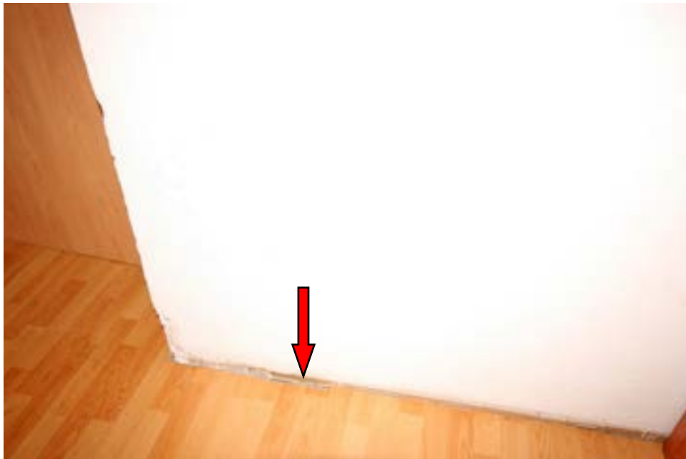
Bild 17: Fehlende Sockelleisten im Schlafzimmer des Bewertungsobjekts (2)
