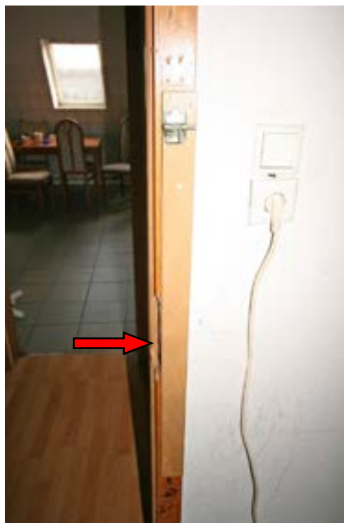
Bild 22: Schadhafte Türzarge im Wohnzimmer des Bewertungsobjekts
