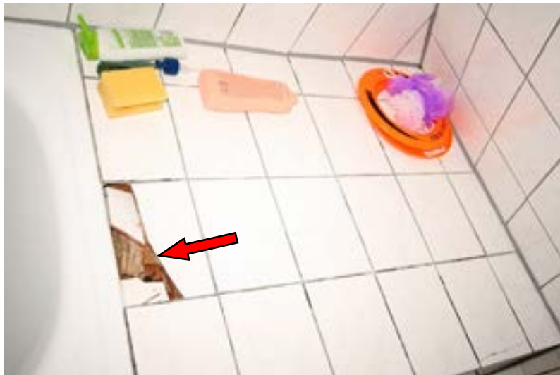
Bild 31: Schadhafte und nicht fachgerecht verlegte Fliesen im Badezimmer des Bewertungsobjekts (2)
