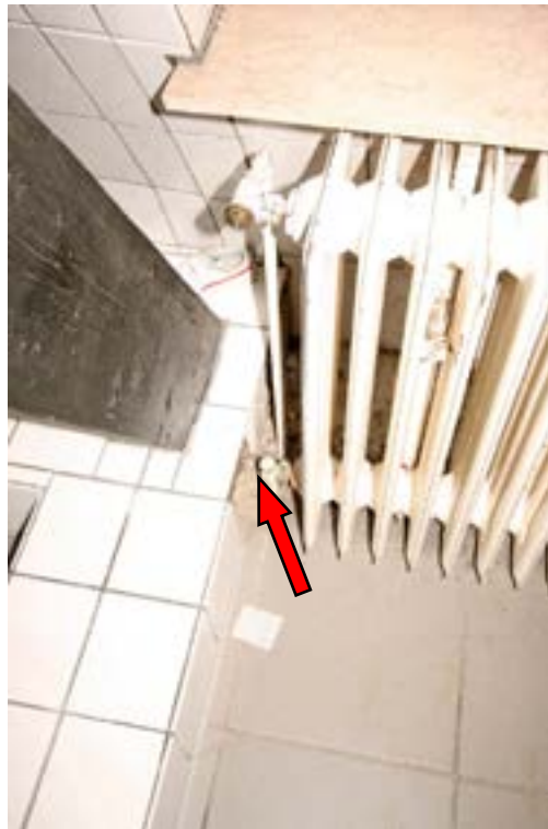
Bild 33: Fehlende Fliesenbekleidung im Badezimmer des Bewertungsobjekts
