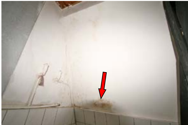
Bild 34: Feuchtigkeitsschäden im Badezimmer des Bewertungsobjekts
