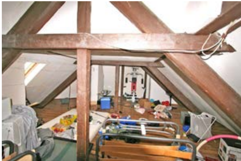
Bild 38: Dachraum (Spitzboden), nicht als Aufenthaltsraum zulässig
