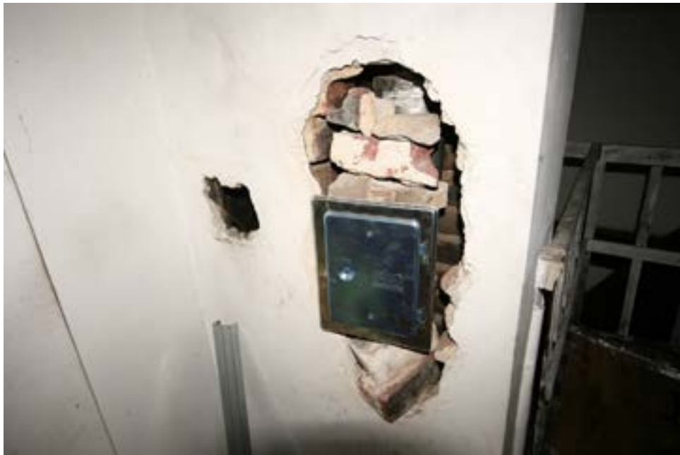
Bild 39: Nicht fachgerecht verschlossener Kamindurchbruch für Revisionsöffnung im Dachraum (Spitzboden) des Bewertungsobjekts
