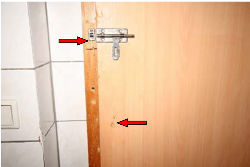
Bild 36: Schadhafes Türelement im Badezimmer des Bewertungsobjekts
