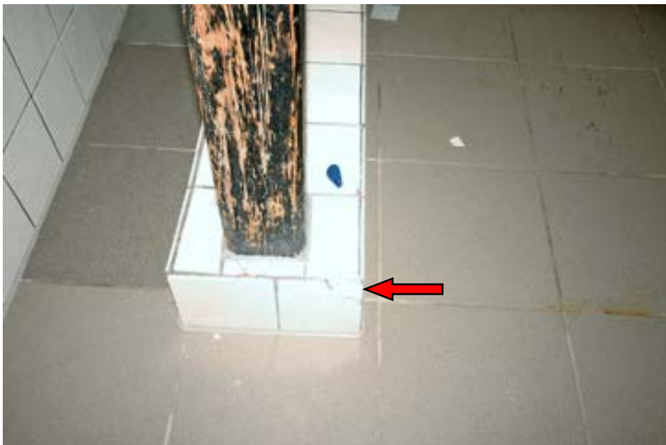
Bild 30: Schadhafte und nicht fachgerecht verlegte Fliesen im Badezimmer des Bewertungsobjekts (1)
