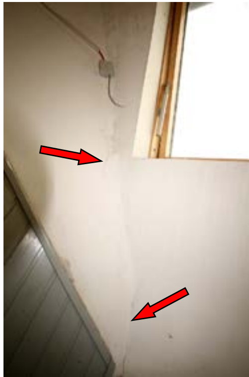
Bild 9: Risse im Dachgeschoss des Treppenhauses des Bewertungsobjekts
