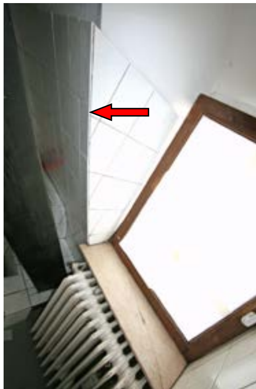
Bild 32: Schadhafte und nicht fachgerecht verlegte Fliesenbekleidung im Badezimmer des Bewertungsobjekts
