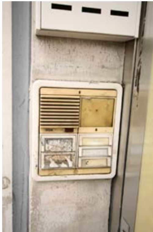
Bild 5: Schadhafte Türöffner-, Klingel- und Gegensprechanlage des Bewertungsobjekts
