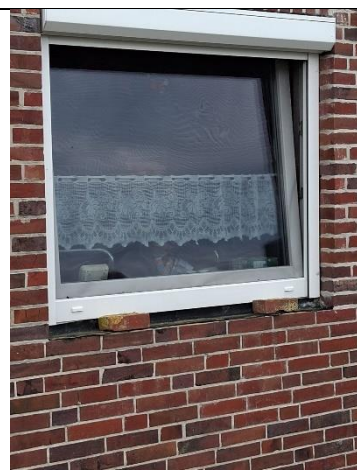
Ansicht Baumängel / Bauschäden u.a.
