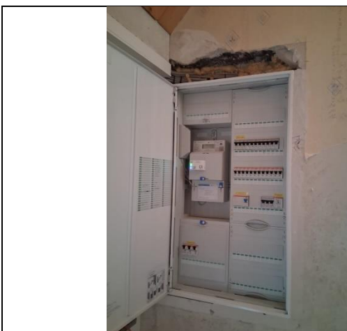
Ansicht Baumängel / Bauschäden u.a.
