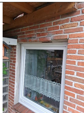
Ansicht Baumängel und Bauschäden u.a.
