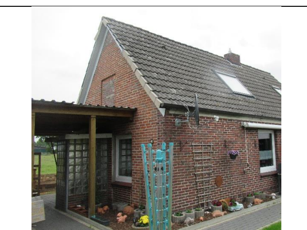
Ansicht Baumängel und Bauschäden u.a.
