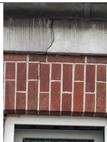
Ansicht Baumängel / Bauschäden u.a.
