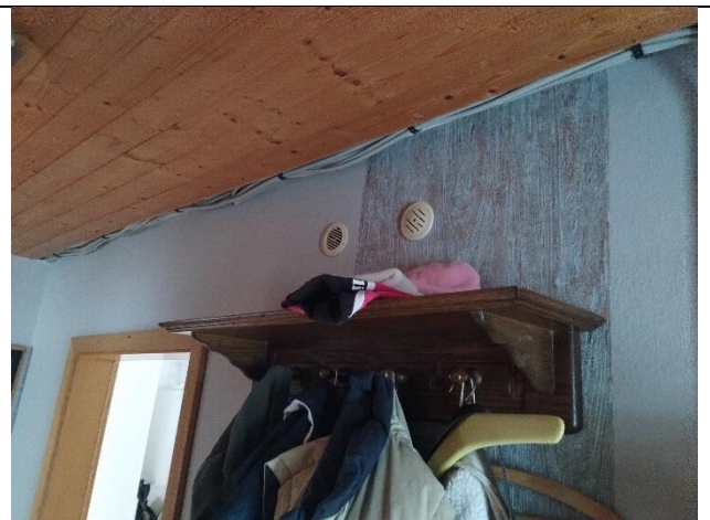
Ansicht Baumängel / Bauschäden u.a.
