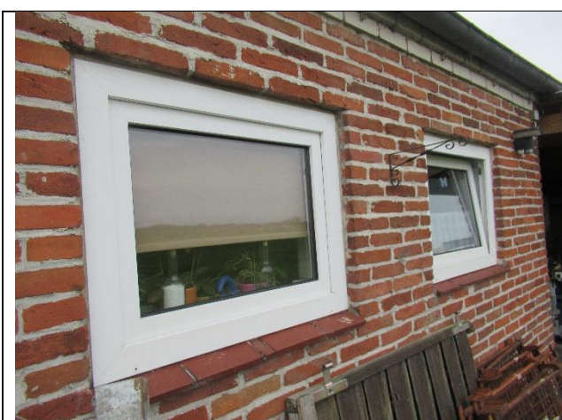
Ansicht Baumängel und Bauschäden u.a.
