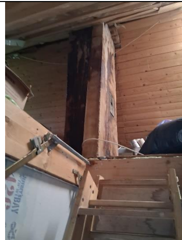
Ansicht Baumängel / Bauschäden u.a.
