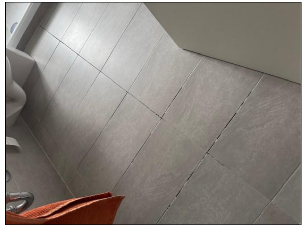
Whg. 4 – 2. OG links / Schäden Fugen im Bad
