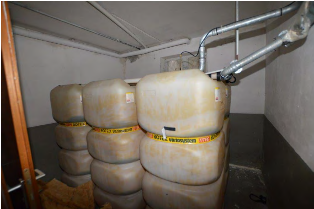
Unter-/ Kellergeschoss – Öltanks
