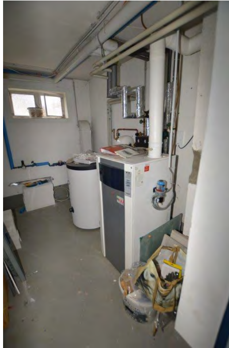
Unter-/ Kellergeschoss – Heizungsanlage
