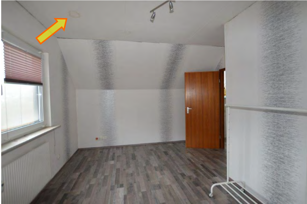
Feuchtigkeitsschden an der Decke im Dachgeschoss
