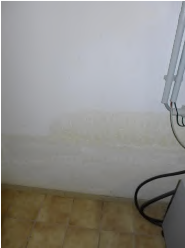
11 a Ausblühungen im Kellergeschoss
