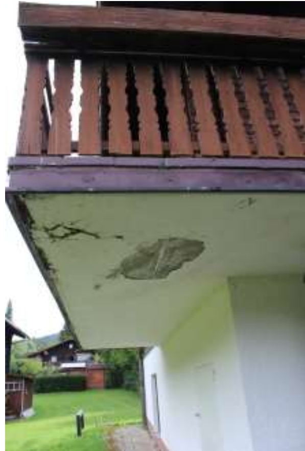
Bild 6: Ansicht Balkonplatten- untersicht Westecke Feriendorf „Hohen Bogen“ 53 von Nordwesten
