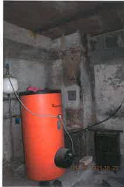
Abstellraum im Rohbau mit WW-Boiler
