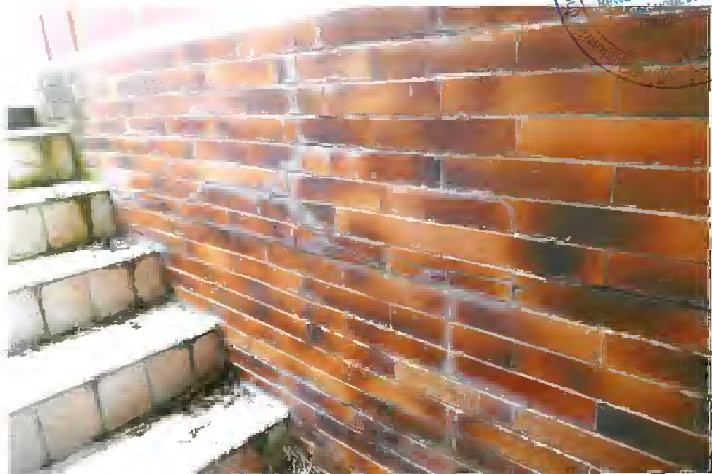
Bild 6: Brüstung Kellertreppe außen durchgerissen
