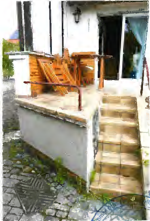
Bild 5: Absturzicherung/Geländer Terrasse seitlich dringend nachzurüsten - Absturzgefahr
