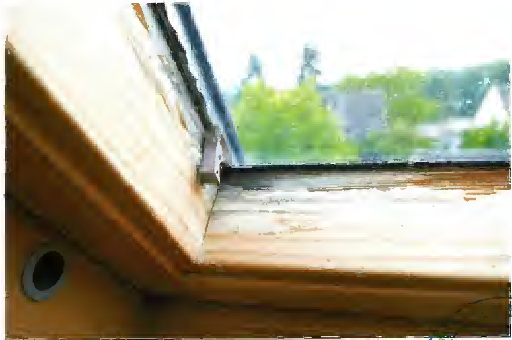
Bild 11: Fenster DG Bad sanierungsbedürftig
