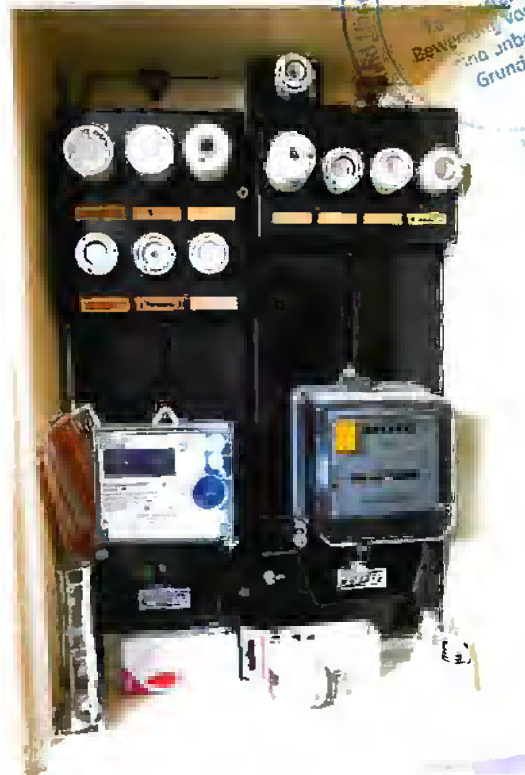
Bild 12: Zählerschrank mit UV (Schraubsicherungen) aus der Bauzeit - FI nicht vorhanden
