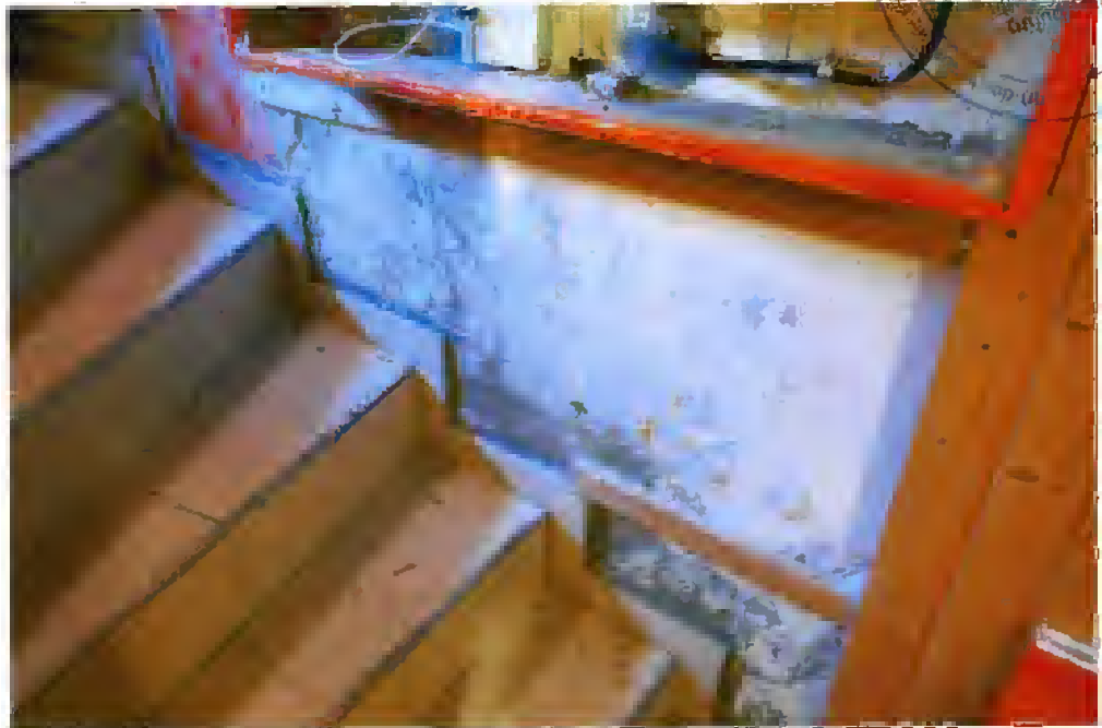
Bild 8: Kelleraußenwände mit Putzablösung und Aussalzung
