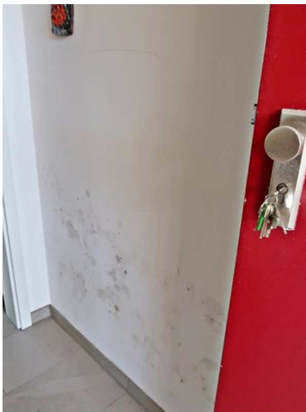
Diele mit Verfärbungen im Wandbereich, messbare Feuchtigkeit war nicht vorhanden
