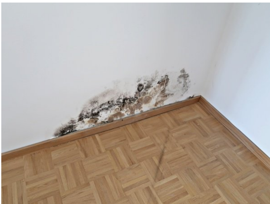
Verfärbungen an der Wandfläche nachträglich abgeteilter Schlafraum
