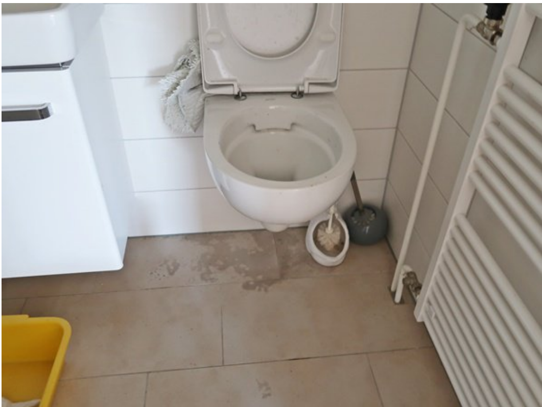
Verfärbungen Boden im Bereich des Hänge-WCs
