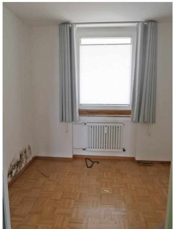
Nachträglich abgeteilter Schlafraum, links Verfärbungen an der Wandfläche
