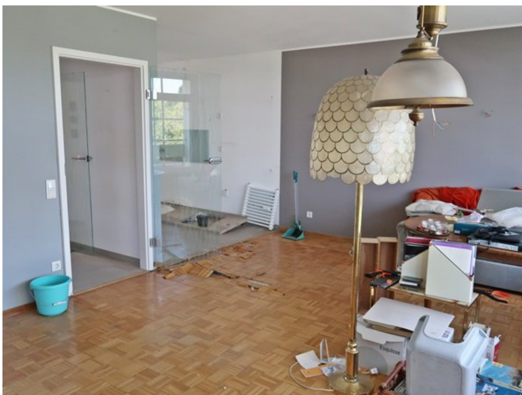
Schäden am Parkettboden Wohnraum
