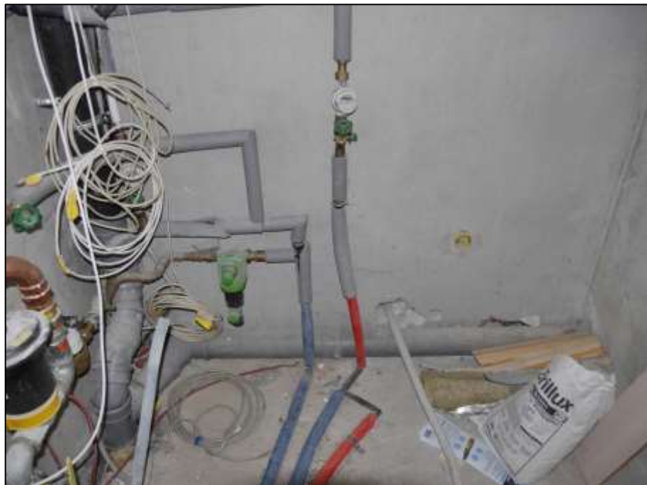
Hausanschlussraum im Erdgeschoss des auf dem Grundstück Budde-str. 31E, Königsweg 24 aufstehenden Reihenmittelhauses
