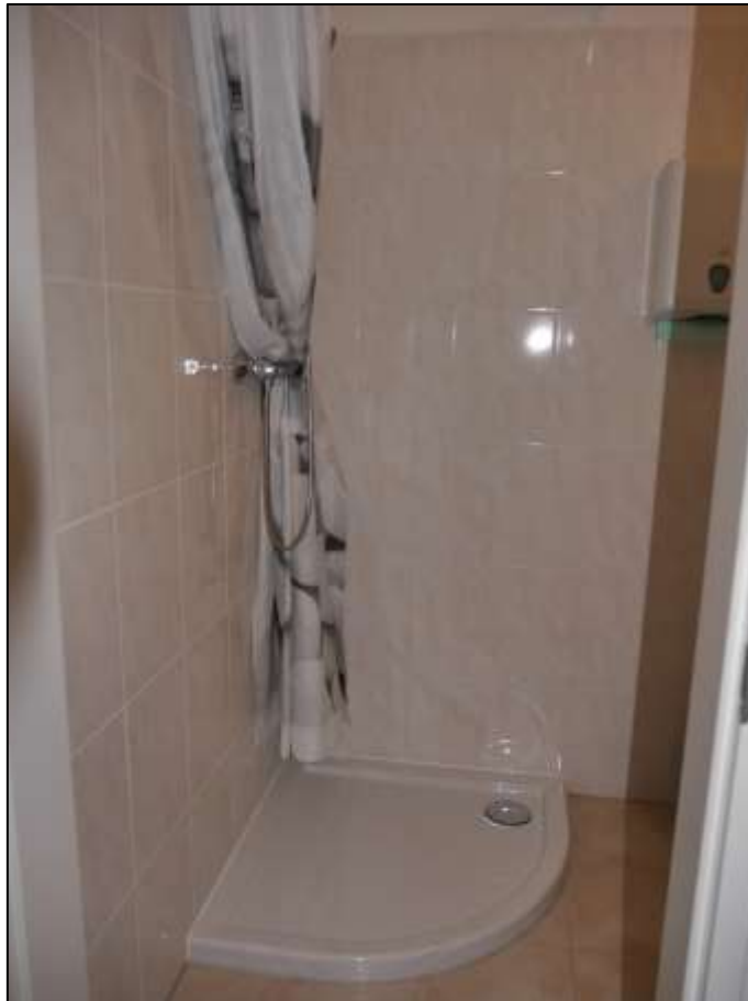
Duschbadezimmer der Gewerbeeinheit im Erdgeschoss des auf dem Grundstück Budde-str. 31E, Königsweg 24 aufstehenden Reihenmittelhauses
