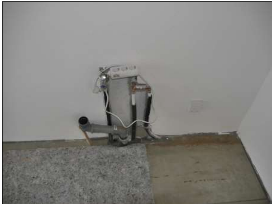
Installationsanschlüsse der Küchenarbeitszeile im Wohn-/Ess-Zimmer mit Küche innerhalb der oberen Maisonette im 4.OG
