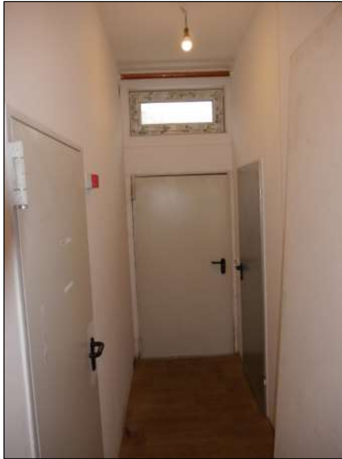
Hauseingangsflur im Erdgeschoss des auf dem Grundstück Buddestr. 31E, Königsweg 24 aufstehenden Reihemittelhauses mit Hauseingangstür im Hintergrund
