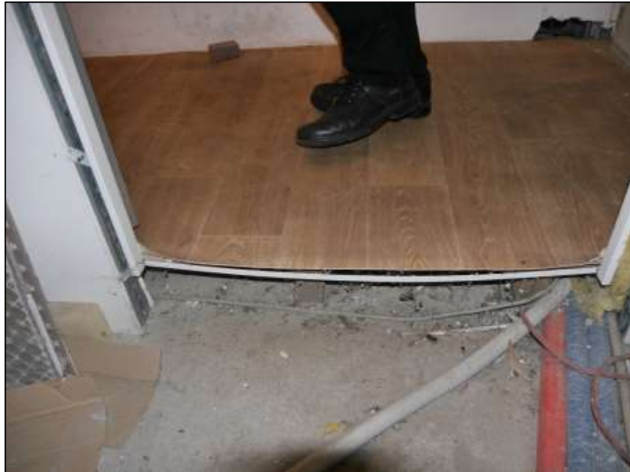
Hausanschlussraum im Erdgeschoss des auf dem Grundstück Budde-str. 31E, Königsweg 24 aufstehenden Reihenmittelhauses mit anbin-dendem Flur und dort provisorischem Boden
