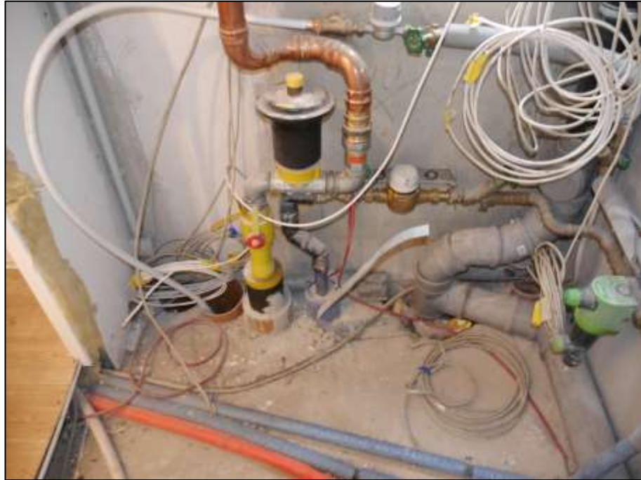
Hausanschlussraum im Erdgeschoss des auf dem Grundstück Budde-str. 31E, Königsweg 24 aufstehenden Reihenmittelhauses
