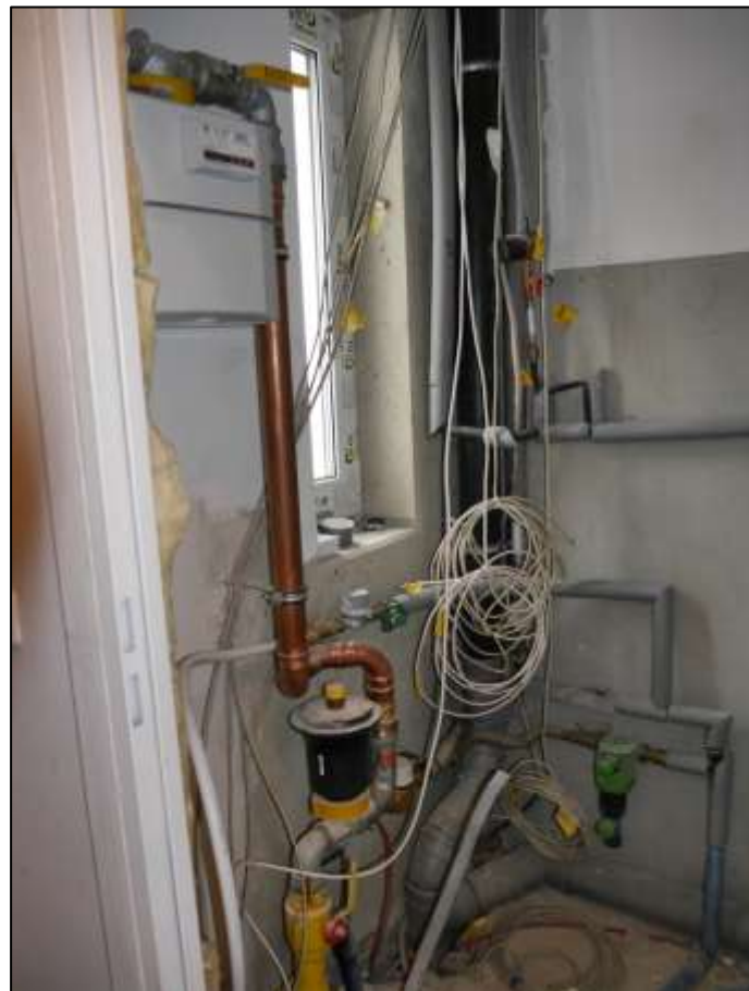
Hausanschlussraum im Erdgeschoss des auf dem Grundstück Buddestr. 31E, Königsweg 24 aufstehenden Reihemittelhauses
