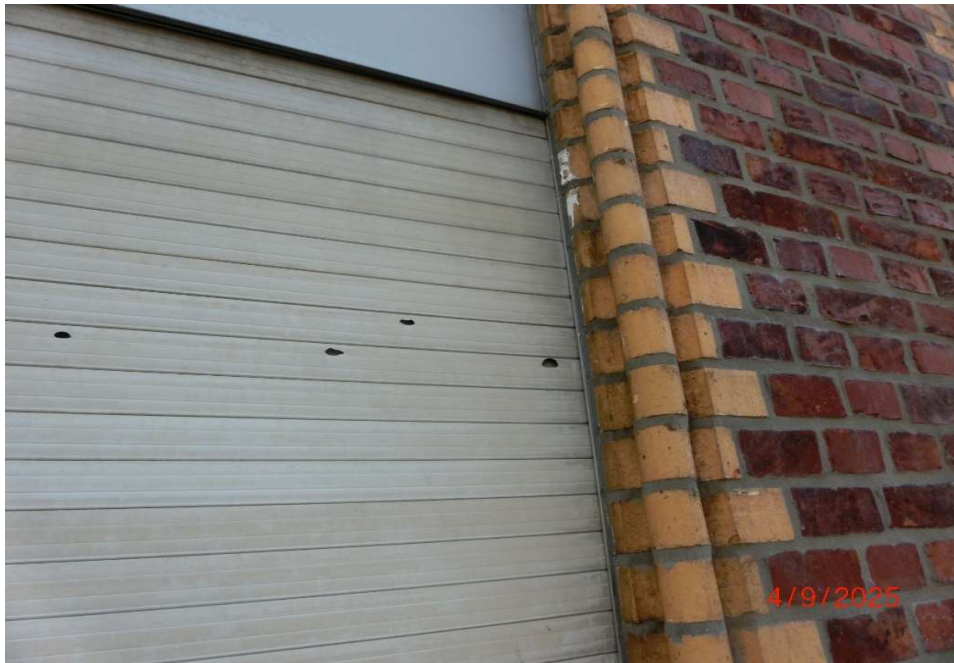
Rollläden mit Hagelschäden
