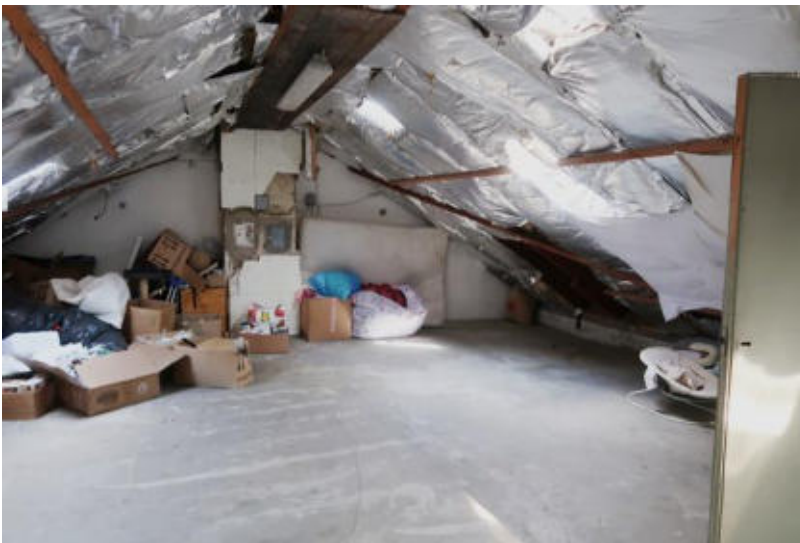
Dachboden mit unkonventionell eingebauter, teilweise schadhafter Dämmung.
