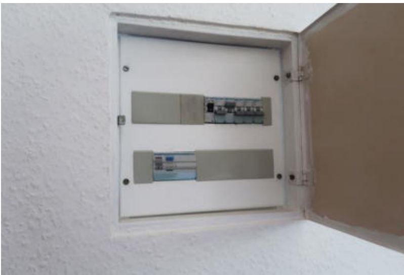
Elektrische Unterverteilung im Anbau.
