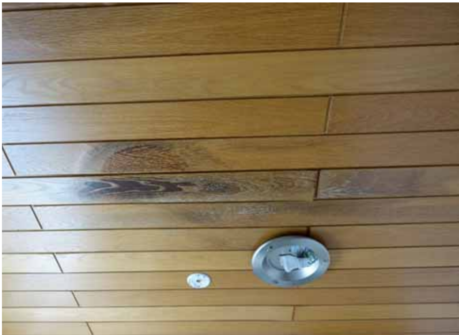
Feuchtigkeitsschäden im Deckenbereich des Zimmers II
