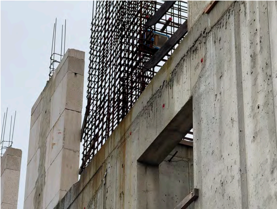
freiliegender Bewehrungsstahl im 2.Obergeschoss
