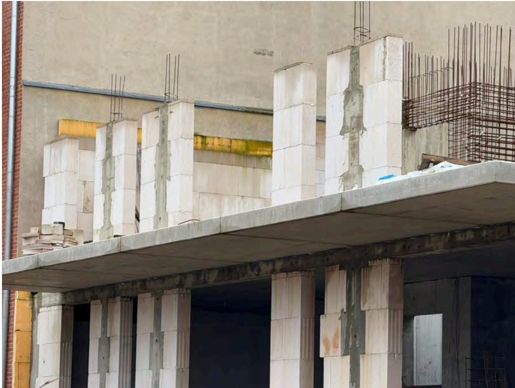
das 2. Obergeschoss des Rohbaus wurde begonnen; Bewehrungsstahl, Geschosdecke und Mauerkrone sind seit mehr als 2 Jahren der Witterung ausgesetzt
