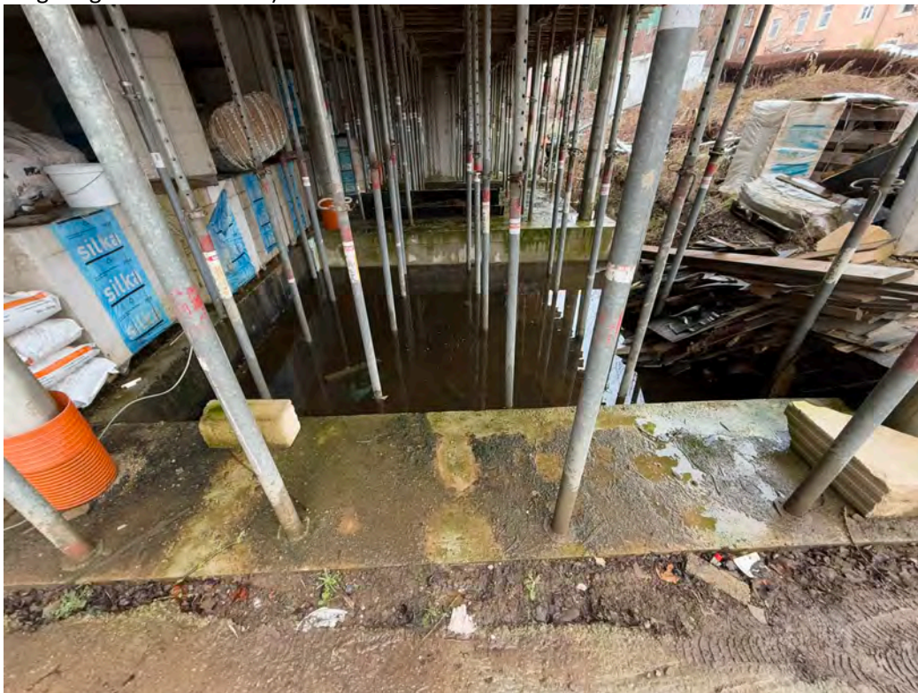
stehendes Wasser im gartenseitigen Anbau
