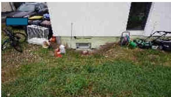
Bild 23: Unterhaltungsstau/Schäden/ Restbauarbeiten (Beispiel)
