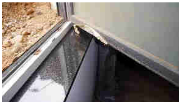
Bild 18: Unterhaltungsstau/Schäden/ Restbauarbeiten (Beispiel)
