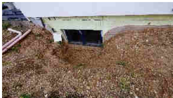
Bild 24: Unterhaltungsstau/Schäden/ Restbauarbeiten (Beispiel)
