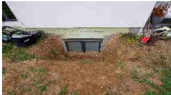
Bild 22: Unterhaltungsstau/Schäden/ Restbauarbeiten (Beispiel)
