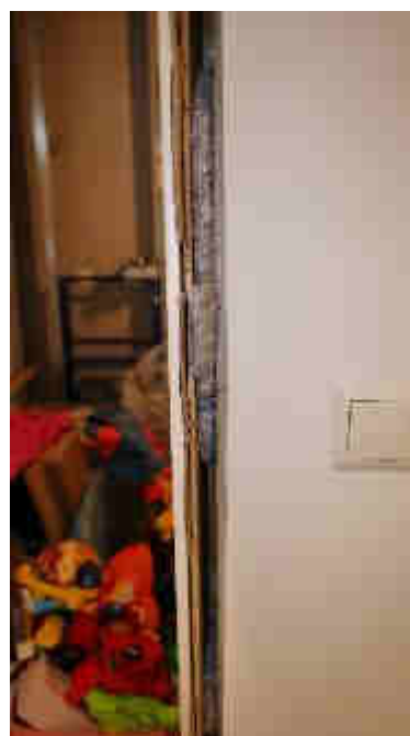
Bild 20: Unterhaltungsstau/Schäden/ Restbauarbeiten (Beispiel)
