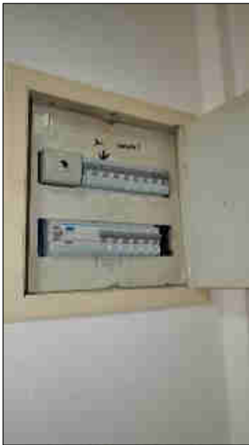
Bild 21: Haustechnik Hinterhaus (Beispiel)
