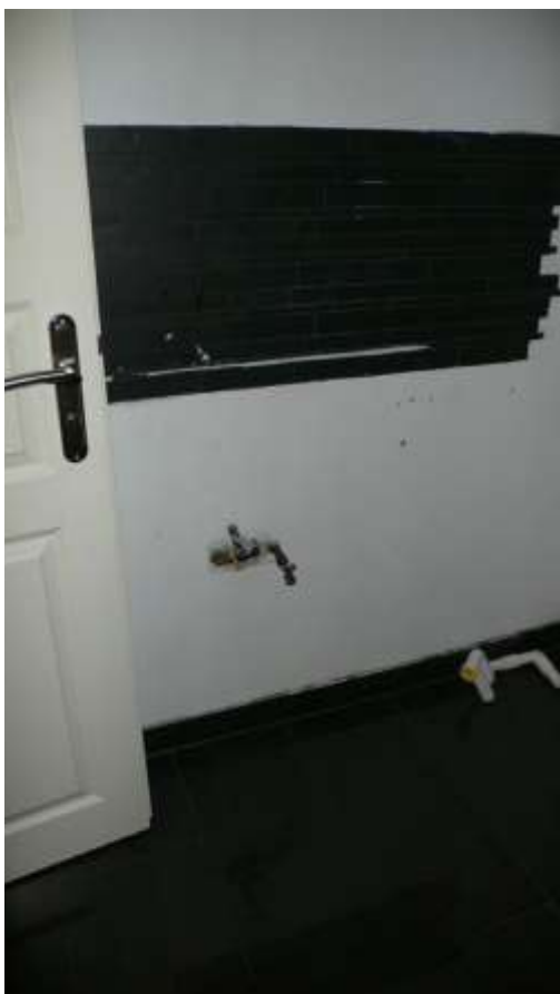
Bilder 53: fehlendes WB im Bad
