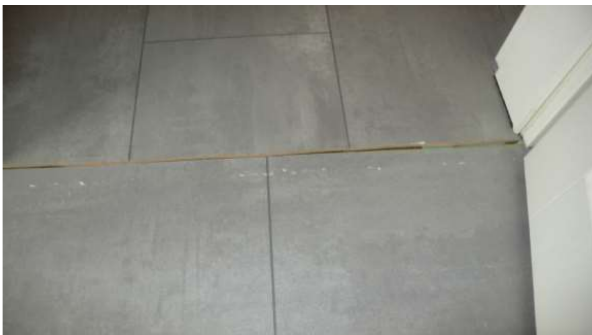
Bild 61: fehlende Dehnungsfuge im Türbereich
