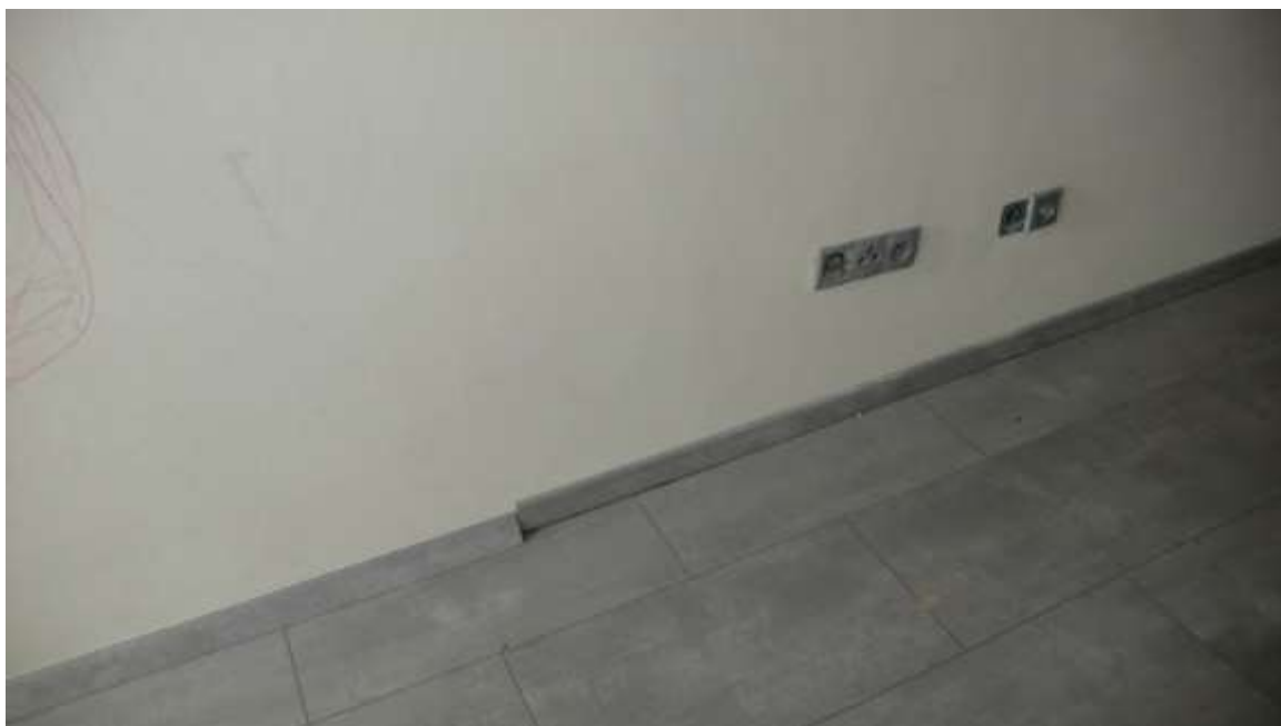
Bild 40: lose Fußbodensockelleiste und Elektroinstallationsdosen
