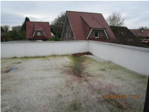
Dachterrasse – Bodenaufbau ist zu überprüfen
