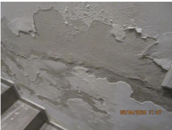
Wasserschaden im Keller
