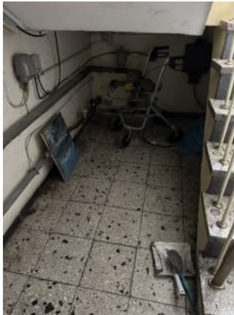
Bild 9: Feuchtigkeitsmerkmale unterhalb der Treppe
