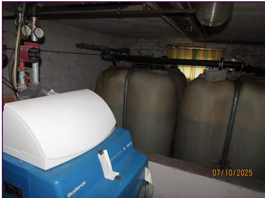
Abbildung 3: Heizraum mit Öltanks im KG.
