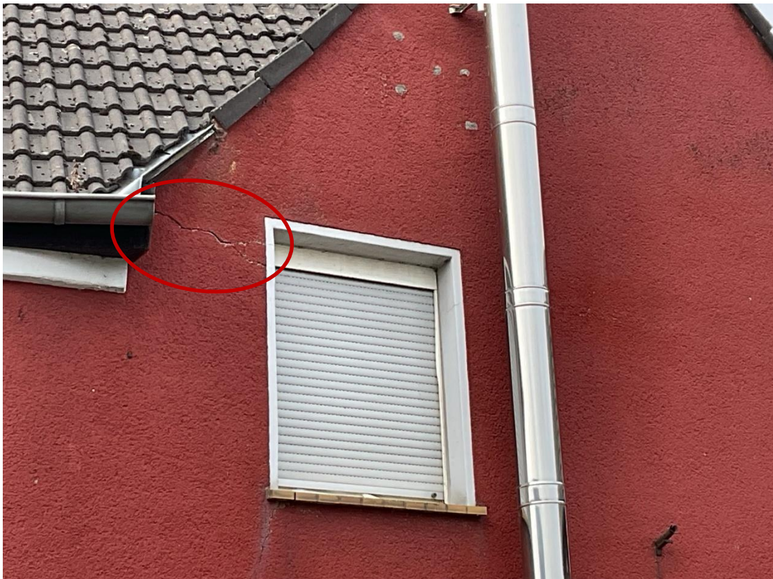
Bild 5: Risse in der Fassade, hier exemplarisch am Fenster DG
