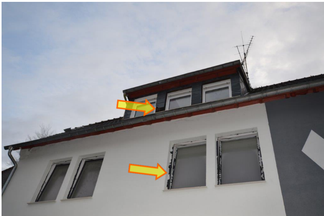
Folie an den Fensterrahmen und Schäden an der Schieferverblendung
