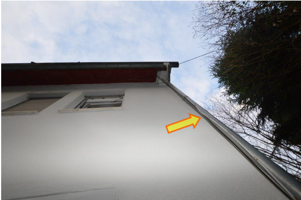
Stromkabel am Fallrohr
