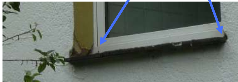
z.T. Putz im Laibungsbereich schadhaft/unvollständig
