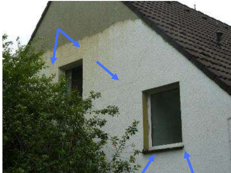
Fassade giebelseitig tlw. mit Rissen
