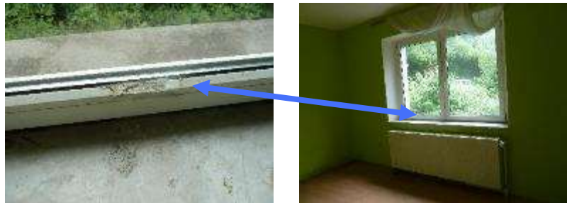
Brandspuren am Blendrahmen (durch Zigaretten vermutet)
