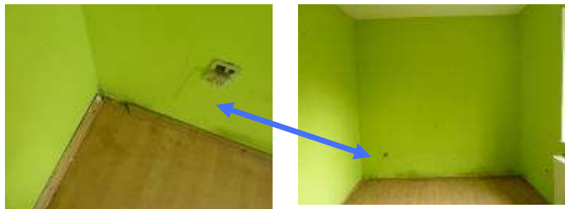
tlw. Elektroinstallation sowie Fußleisten nicht fertiggestellt, z.T. Verfärbungen im Wand- und Bodenbereich
