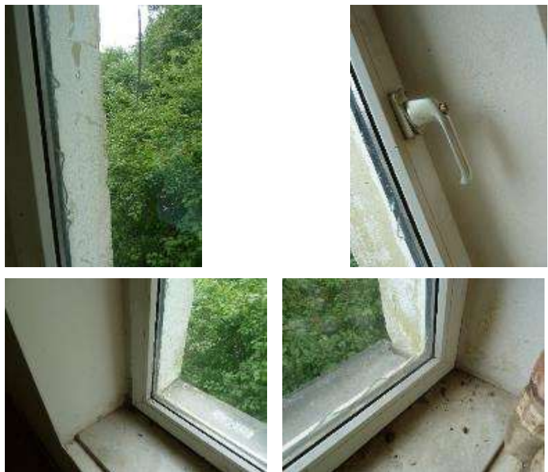
Fensterscheibe außen zerbrochen, Griff defekt
