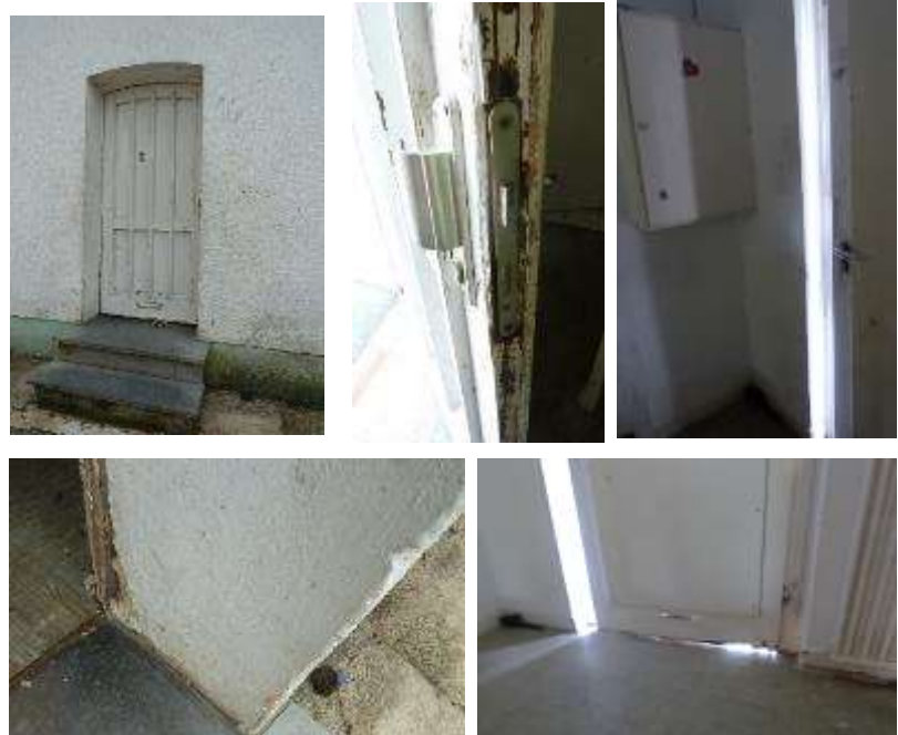
Hauseingangstür mit erheblichen Gebrauchsspuren, tlw. Verfärbungen im Wand-, Sockel- und Bodenbereich
