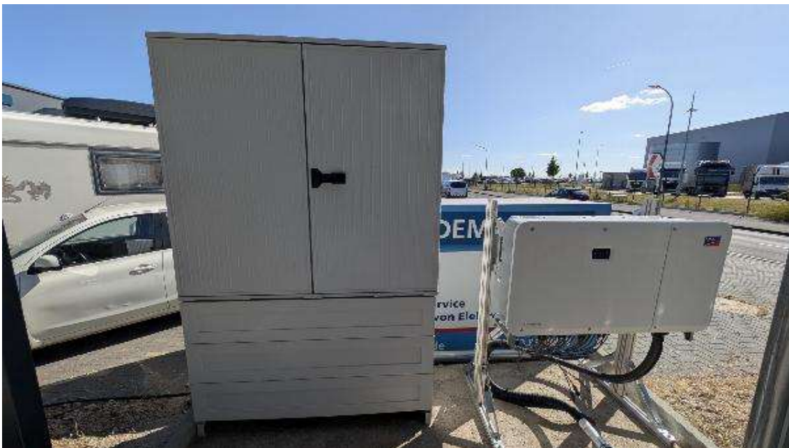
Bild B10 Beispiel Schaltschrank auf Flurstück 187
