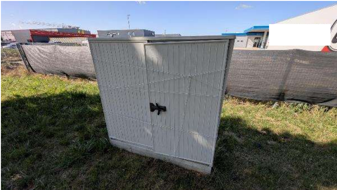
Bild B3 Schaltschrank auf Flurstück 190
