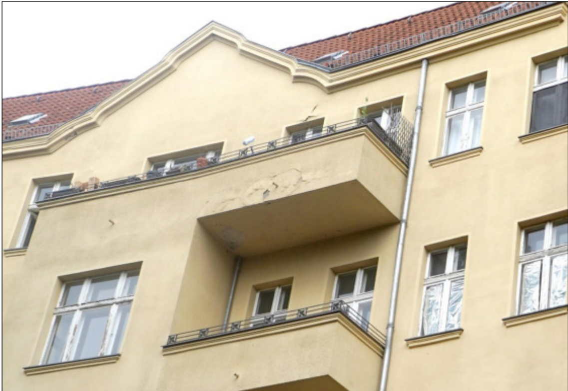
Putzschäden im Fassadenbereich / Balkon
