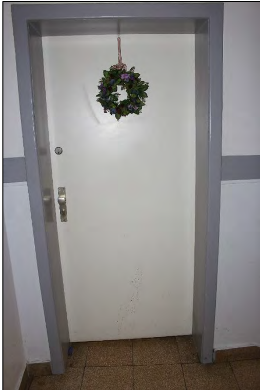
Foto Nr. 29: Gemeinschaftstreppehaus, 2. OG links, Eingang ETW Nr. 16
