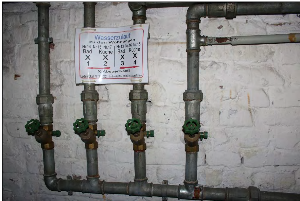
Foto Nr. 17: Kellergeschoss, Flur / Wasserzulauf
