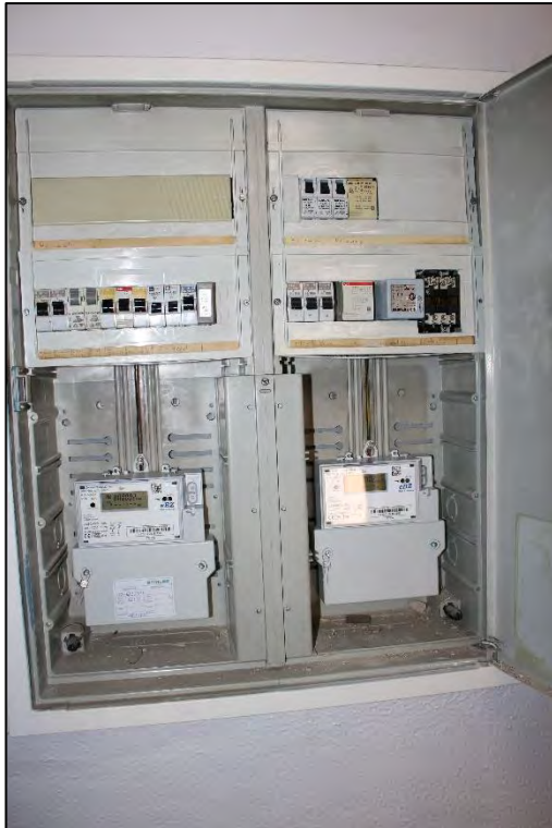
Foto Nr. 27: Gemeinschaftstreppehaus, 2. OG, Elektrounterverteilung
