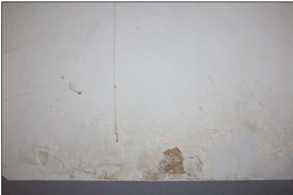
Foto Nr. 28: Gemeinschaftstreppehaus, 2. OG, Feuchteschäden Wand
