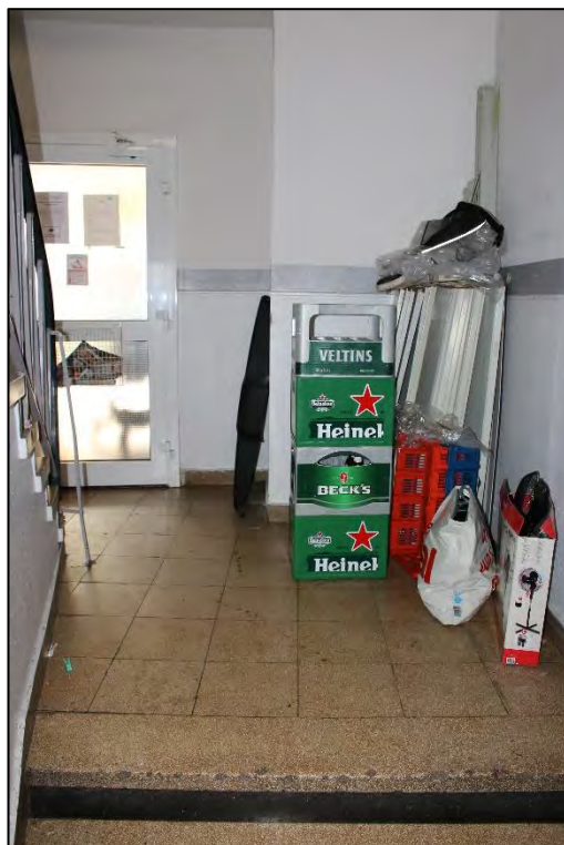
Foto Nr. 12: Gemeinschaftstreppe, Erdgeschoss
