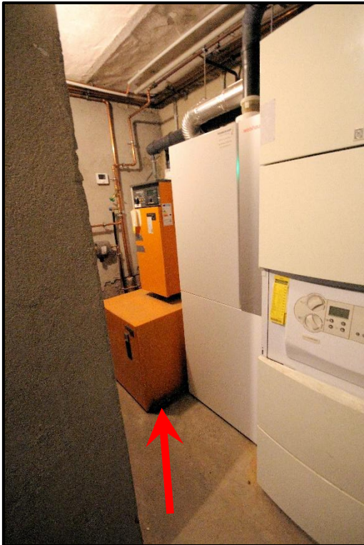
Bild 40: separate Heizungsanlagen für jede Wohneinheit
