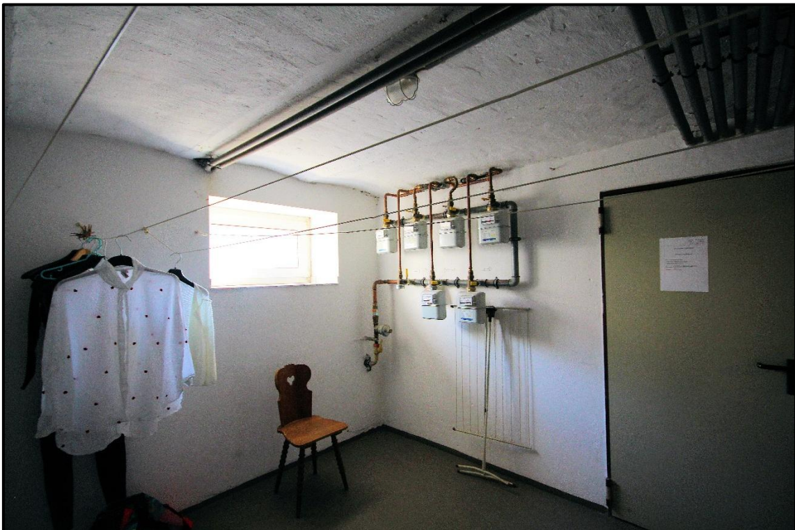
Bild 46: wie vor mit separaten Gaszählern
