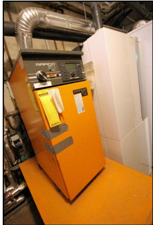
Bild 41: Heizungsanlage, augenscheinlich aus dem Baujahr der Erweiterung
