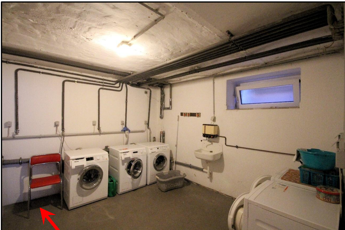
Bild 44: Wasch- und Trockenkeller mit separaten Stellplätzen und Anschlüssen für Waschmaschinen
