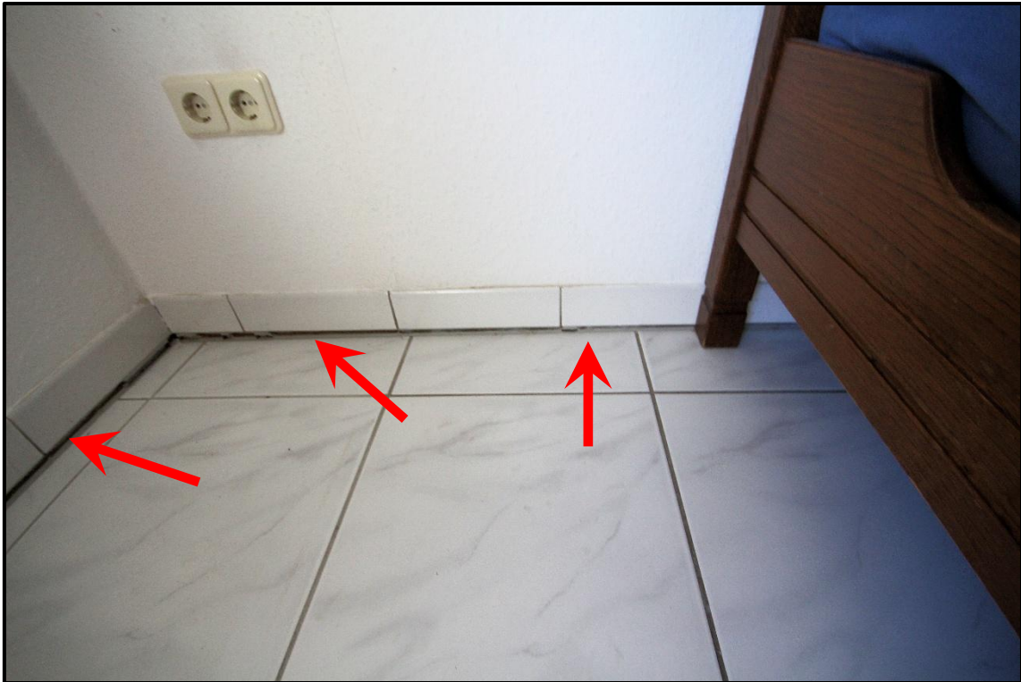
Bild 24: Fugenrisse durch Setzen des Estrichs in mehreren Räumen des Wohnungseigentums Nr. 1 im Erdgeschoss links
