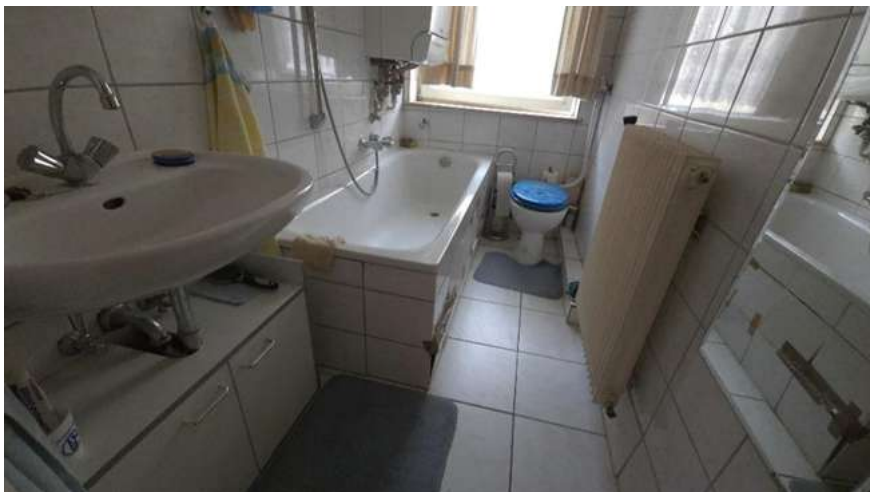
Bad/WC mit sich ablösenden Fliesen im Bereich der Wanne.
