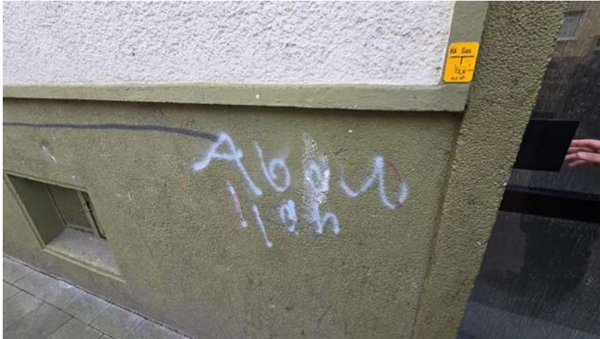
Verschmutzte Fassade im Bereich des Hauseingangs.
