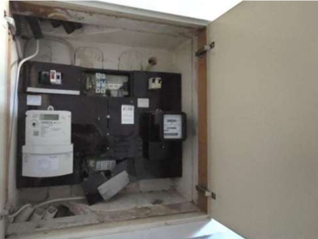
Zählerschrank mit Sicherungsautomaten.
