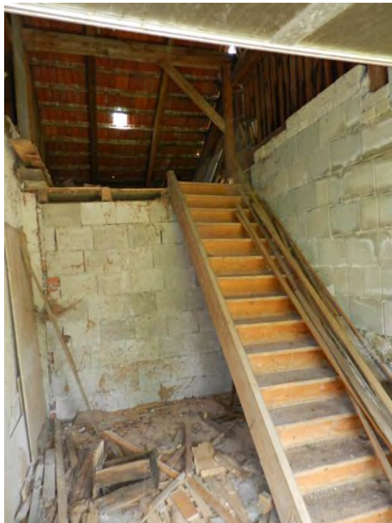
Garage West, rechte Seite; linke Seite konnte nicht besichtigt werden
