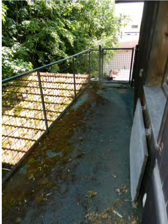
Obergeschoss, Wohnung Ost, Balkon (nach Angabe baufällig)
