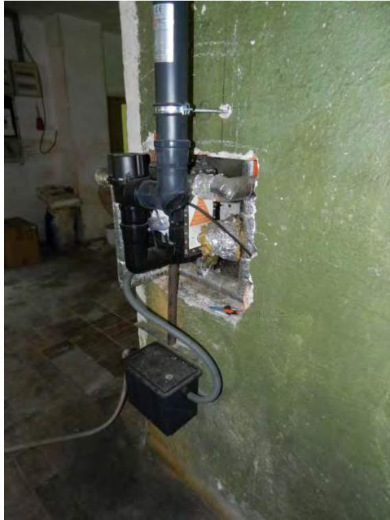
Erdgeschoss, gewerbliche Nutzflächen; Kaminanschluss zu Heizkessel
