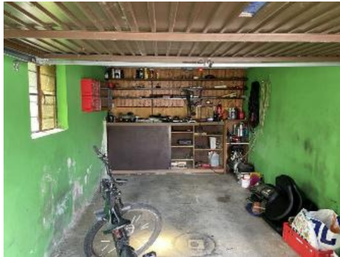
Feuchtigkeitserscheinungen in der Pkw-Garage
