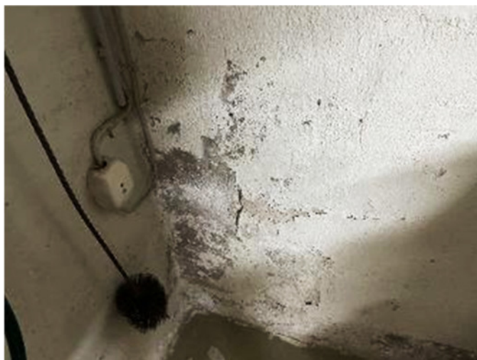
Feuchtigkeitserscheinungen im Kellergeschoss
