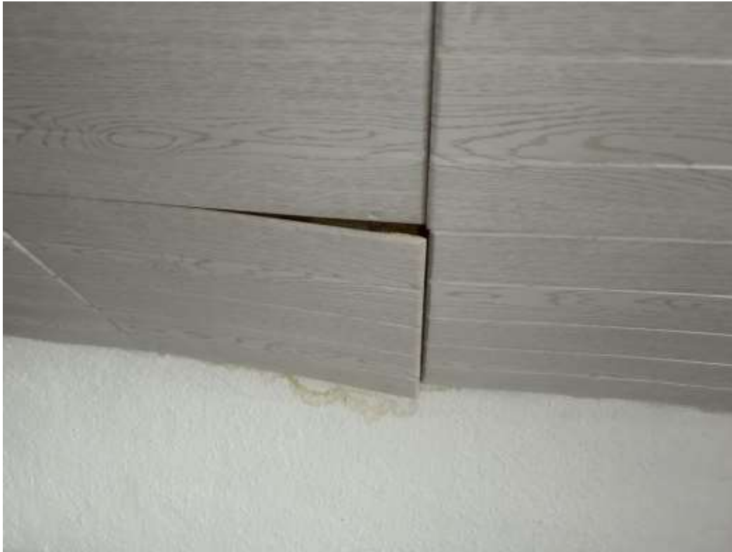
Anlage 5.9: Bild 9 Durchfeuchtung Dachschräge Wohnraum Dachgeschoss
